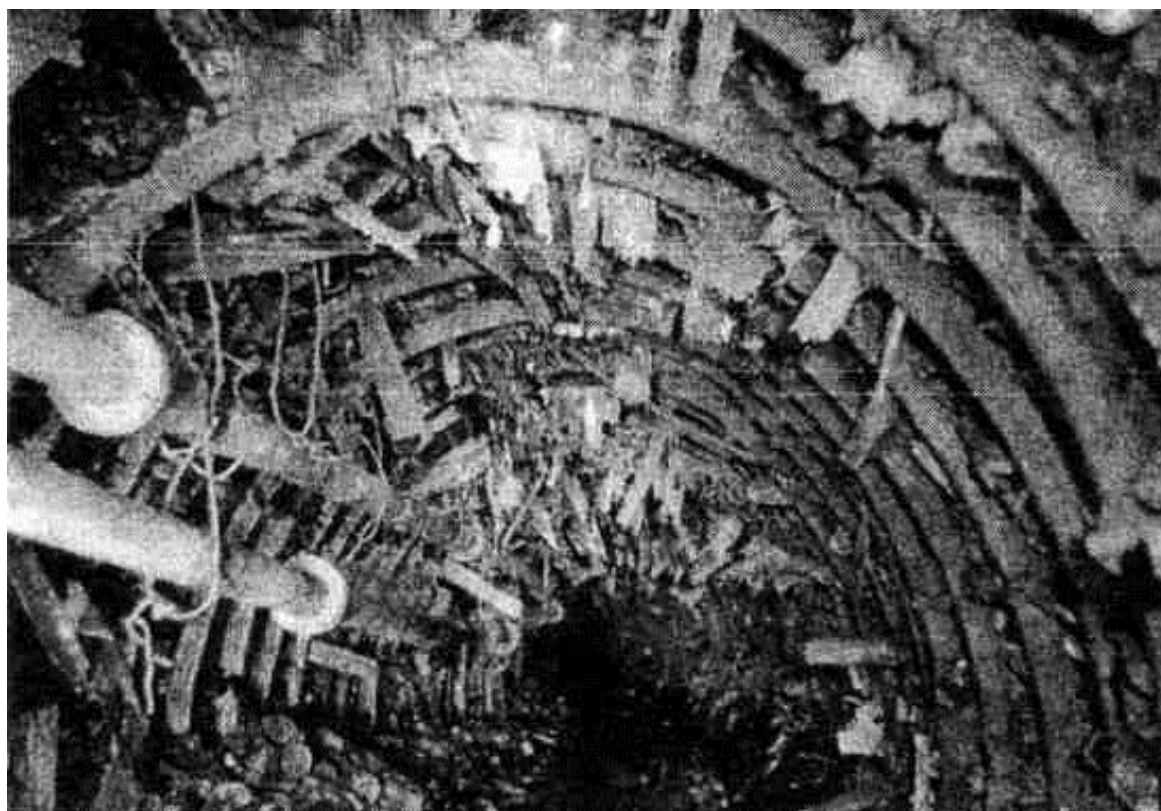
Рис. 2.2 Типичное состояние отказов деревянной затяжки в горной выработке.
